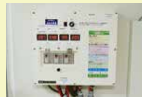
▲蓄電池システム配電盤
